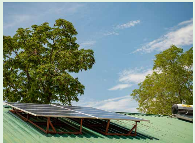
► Die Solaranlage auf dem Dach liefert Energie für den täglichen Gebrauch. gb
